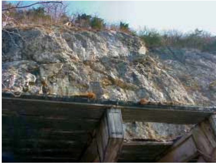
Abb. 3: Der Felssturz an der Axenstrasse zerstörte die Galerie der A4 (Bild: R. Chikatamarla).
